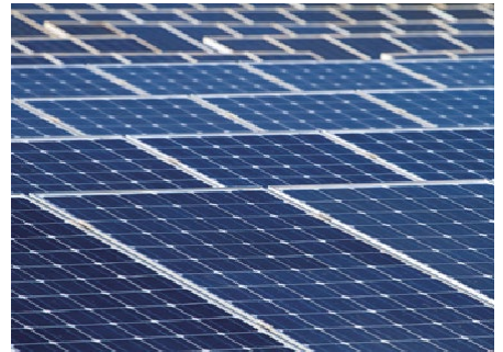
太陽光発電システムの負荷テスト
