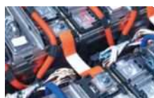
バッテリーバスバーの接続抵抗
