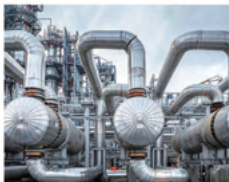
石油化学工場
