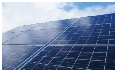
メガソーラの開放電圧測定に DC1700V 測定 DT4254 のみ
